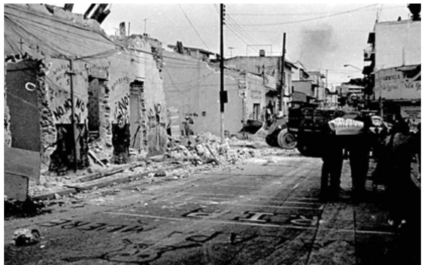
FIGURA 2. Protestas ciudadanas ante la demolición de casas antiguas por la ampliación del acotamiento de la calle Xalapeños Ilustres (Fuente: Xalapa en la historia, 2017).
